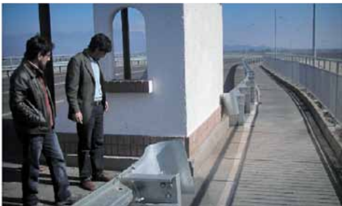
Foto 36: Profesionales de Vialidad y de la Subsecretaría de Transportes observan la ciclovia en el Puente La Puntilla
